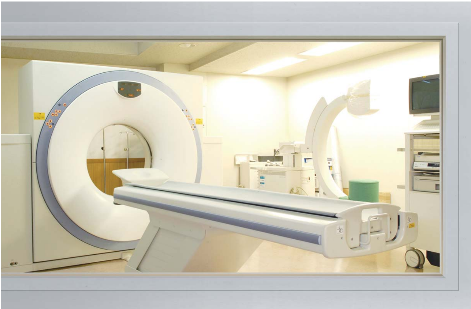
CT 室監視窓
